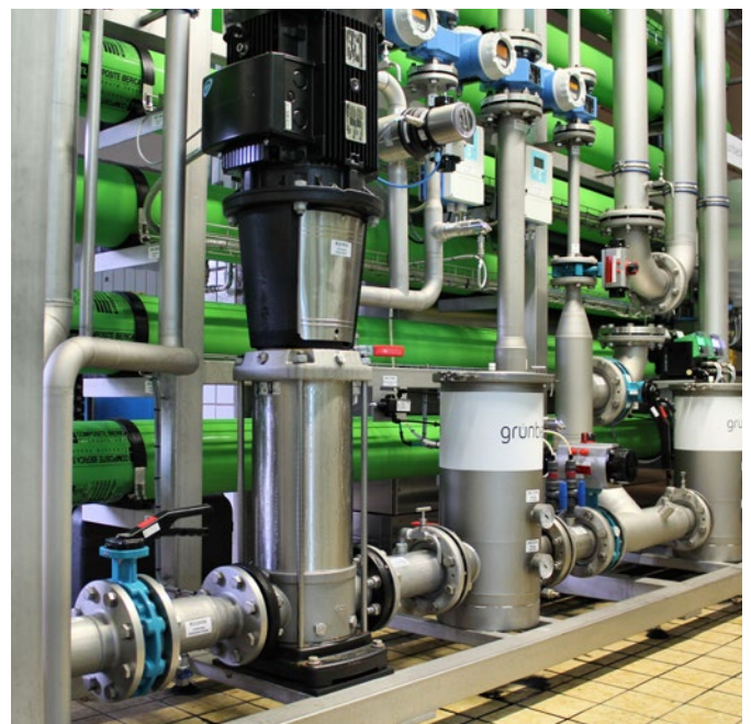
Vorbereitung für die Umkehrosmose in der Meerwasserentsalzung
